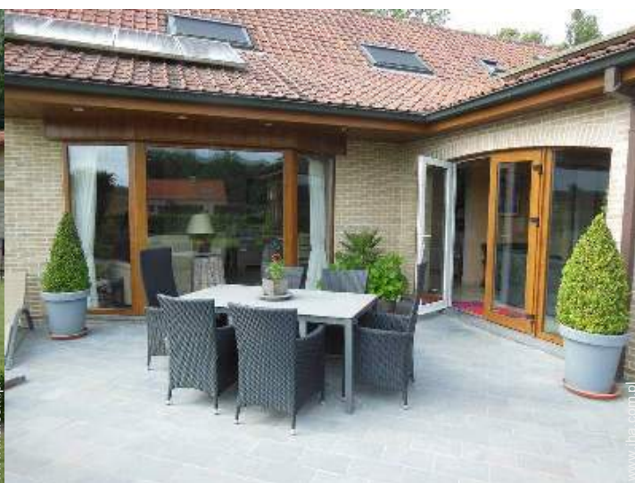
Zainstalowane na zewnątrz objekty
